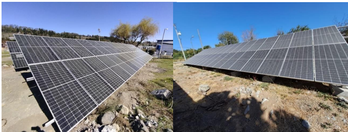
21.- Proyecto cogeneración fotovoltaica agua potable rural Trupán y agua potable rural Polcura, Huépil.
