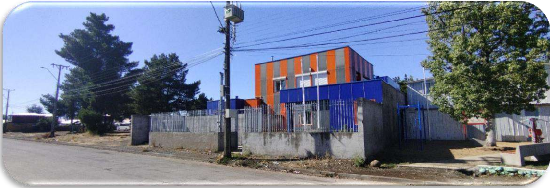
15. Construcción sala cuna y jardín infantil, Villa Cordillera, Huépil, Comuna de Tucapel.
